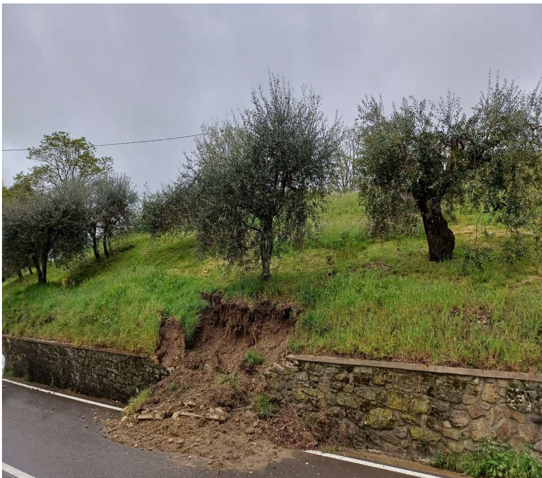
Foto 1: SP 503 materiale instabile in strada e muro caduto
