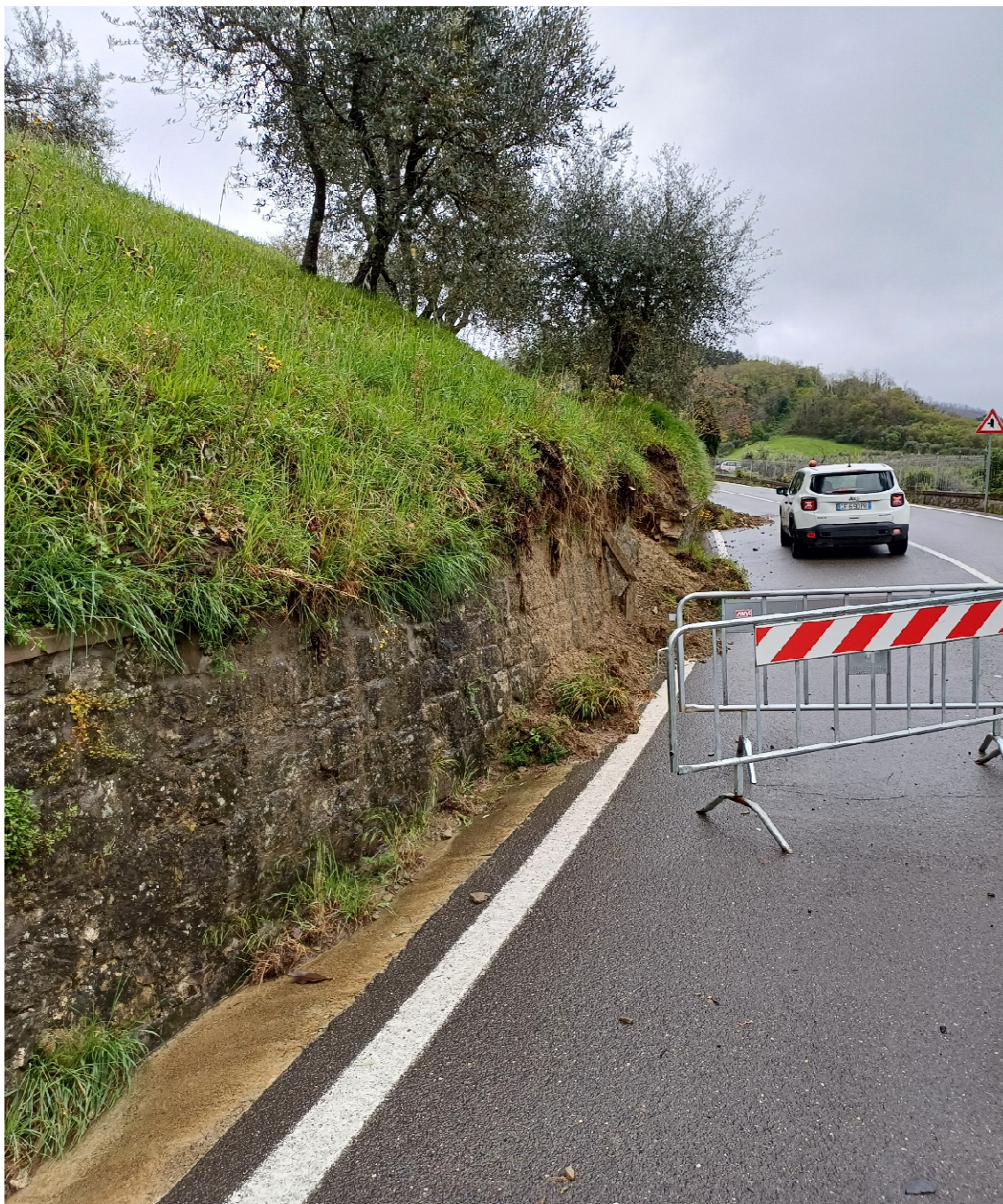
Foto 3: SP 503 materiale instabile in strada e muro compromesso
