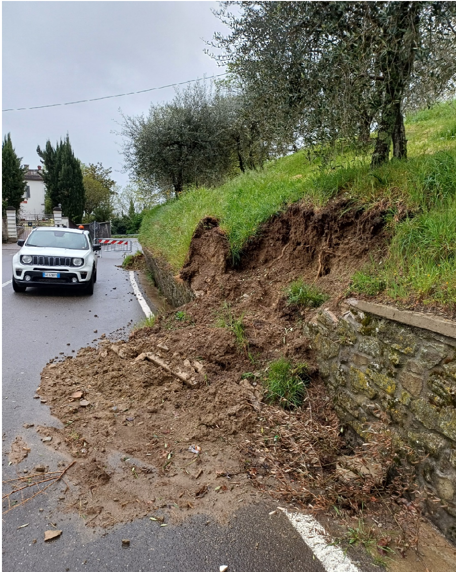
Foto 2: SP 503 materiale instabile in strada e muro caduto
