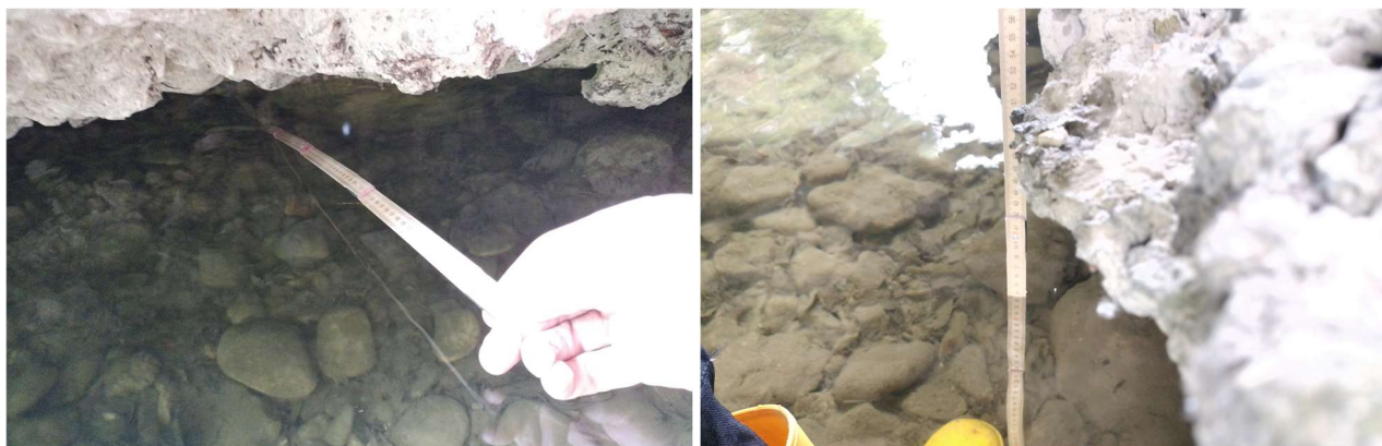
Fenomeno avanzato di scalzamento della pila e della spalla
