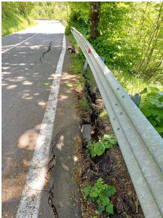
Figura 3 SP 503 Km 21+300 frana di valle
