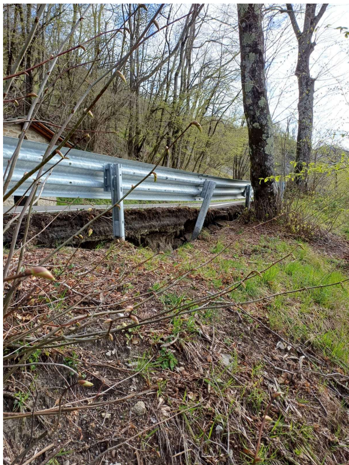
Figura 5 SP 503 Km 21+300 frana di valle
