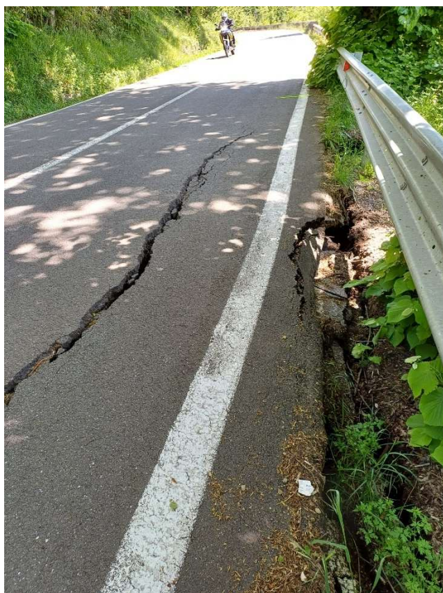
Figura 4 SP 503 Km 21+300 frana di valle
