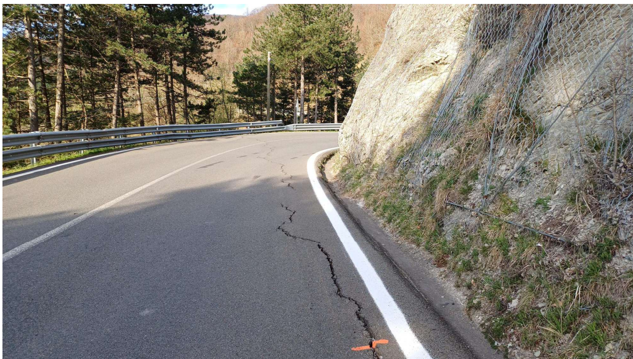
Foto 1: SP 503 km 16+900 lesione longitudinale lungo la carreggiata
