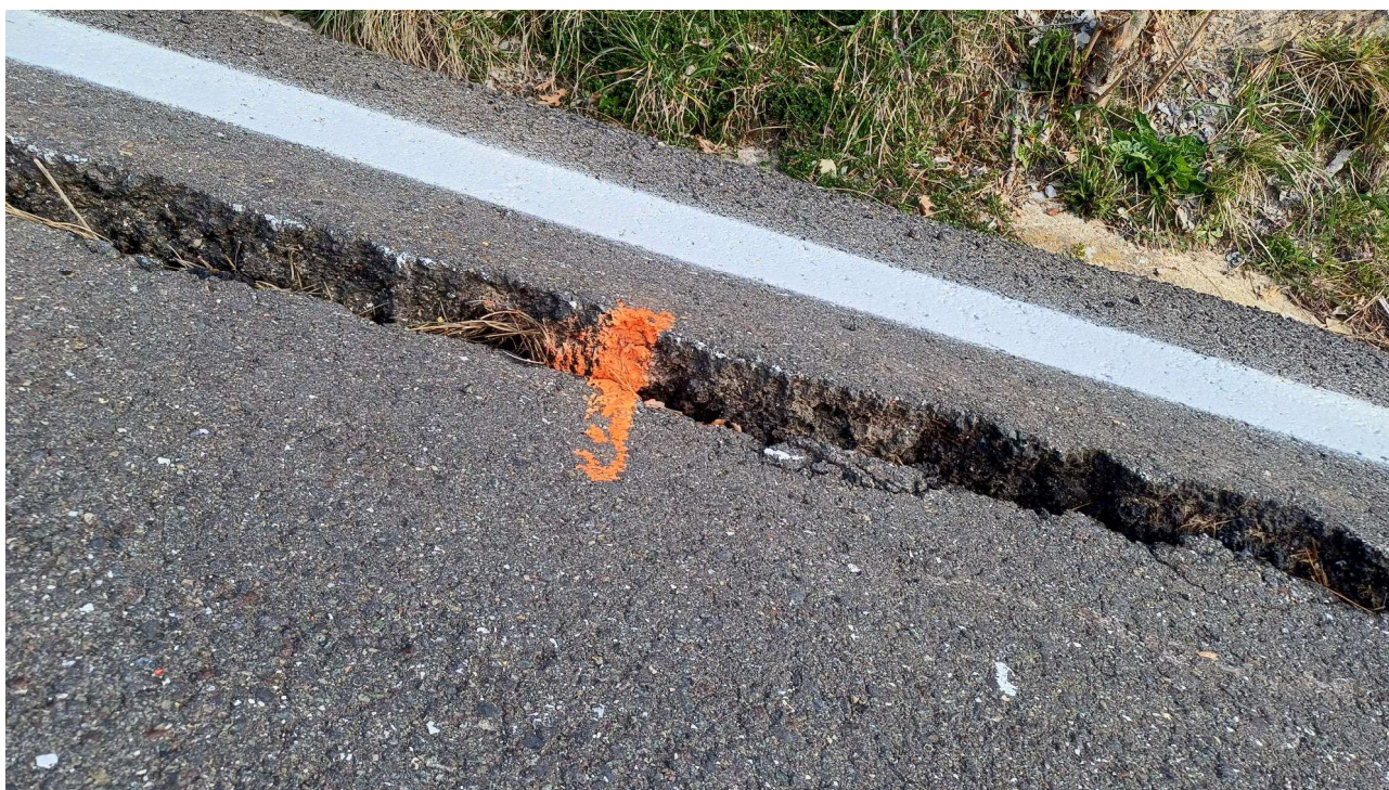
Foto 2: SP 503 km 16+900 particolare lesione longitudinale lungo la carreggiata
