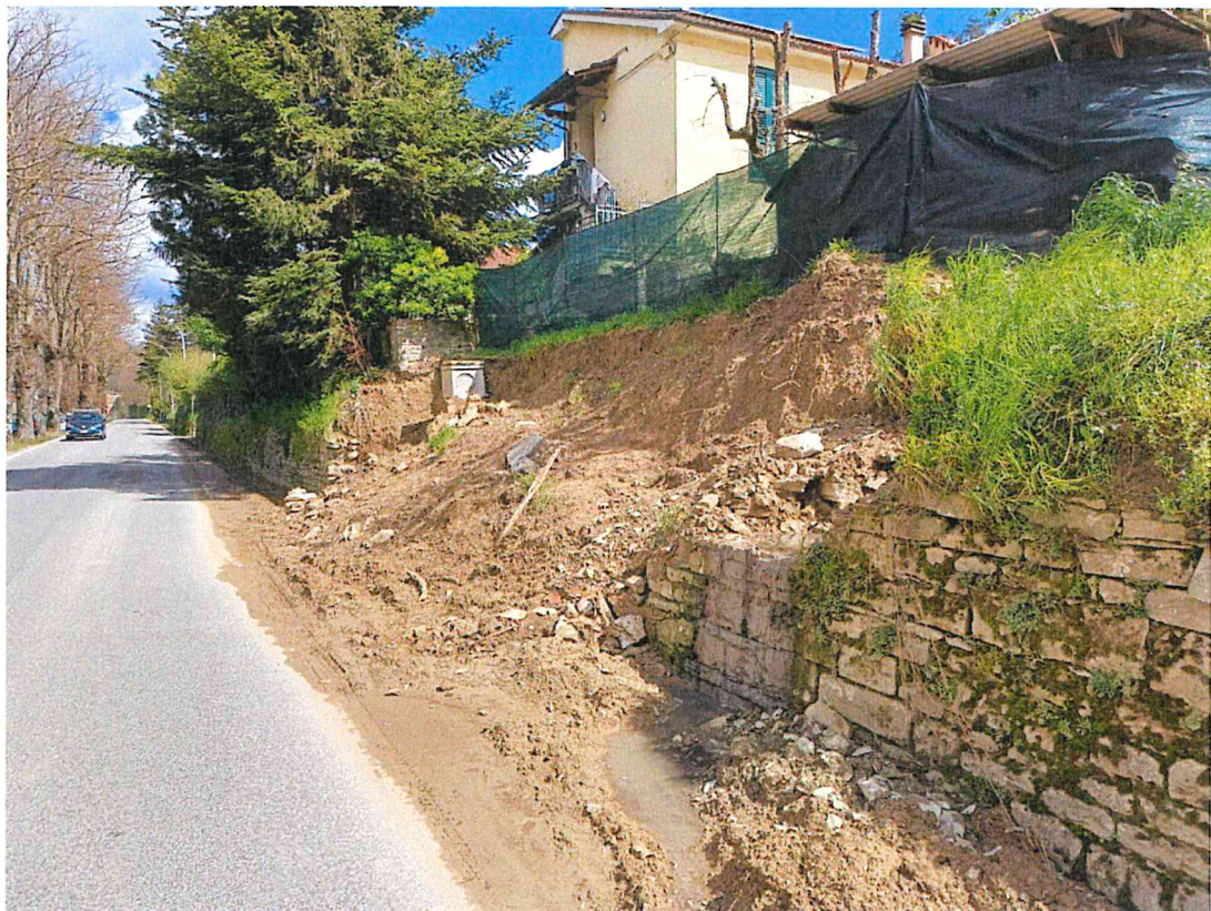
Foto 1: SR 302 km 62+700 Muro di sostegno scarpata franato
