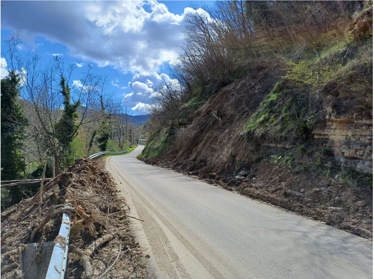
Foto 3: SP 74 materiale instabile in strada e rischio caduta massi
