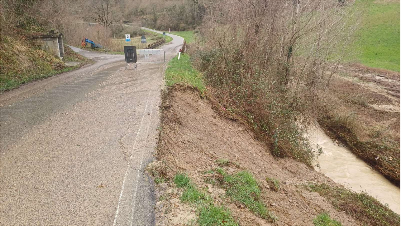
Figura 4 SP 74 Km 3+000 frana di valle
