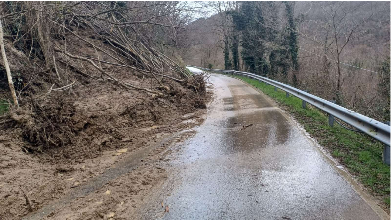
Figura 5 SP 74 Km 4+400 frana di monte
