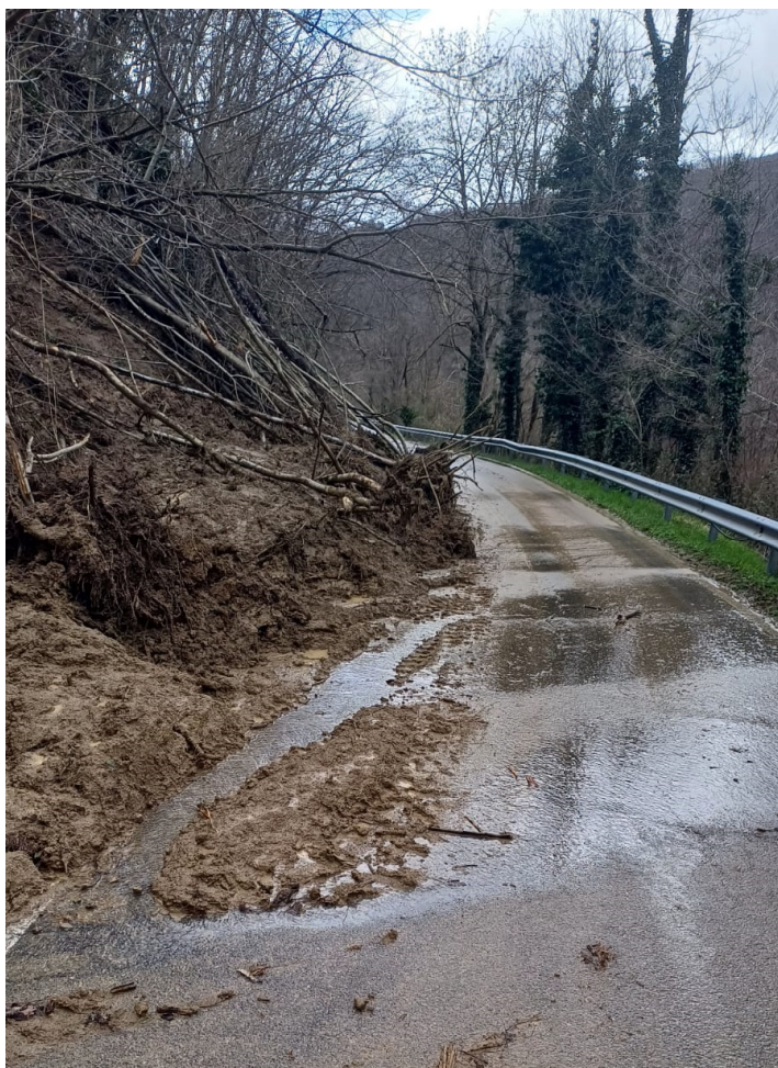
Figura 6 SP 74 Km 4+400 frana di monte
