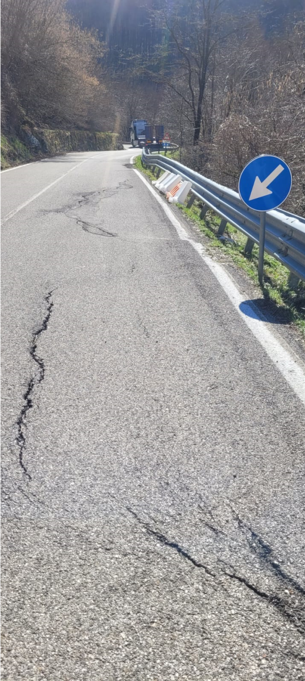
Figura 4 SP 477 Km 12+800 frana di valle
