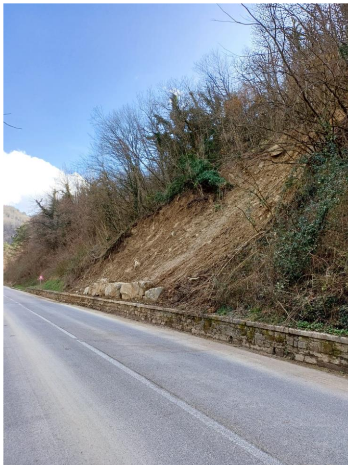
Foto 1: SP 306 km 35+100 frana di monte con materiale instabile presente in scarpata
