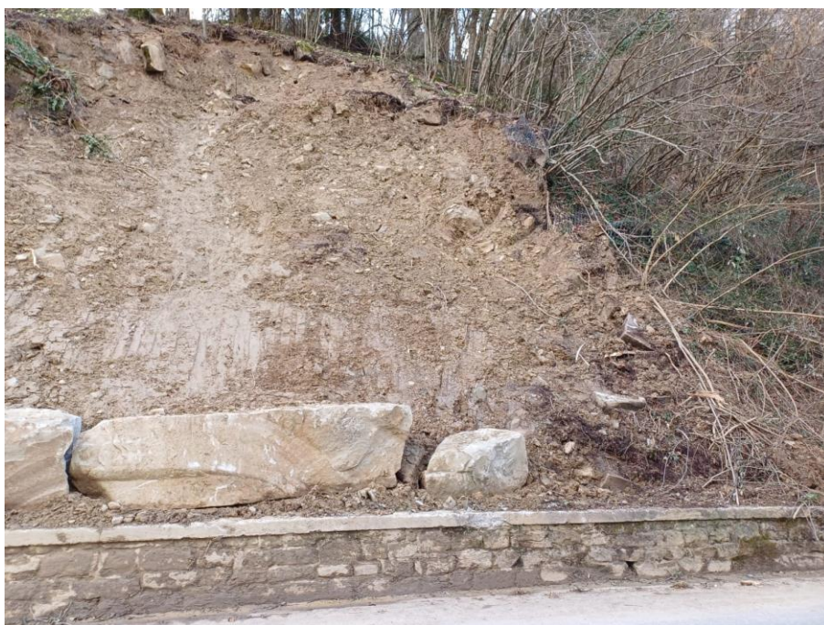
Foto 2: SP 306 km 35+100 frana di monte con materiale instabile presente in scarpata
