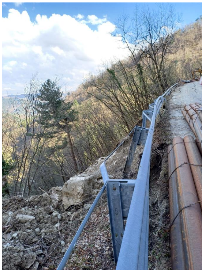
Figura 4 Foto SP 306 Km 45+500 frana di valle
