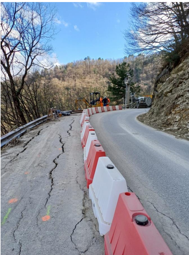
Figura 3 Foto SP 306 Km 45+500 frana di valle
