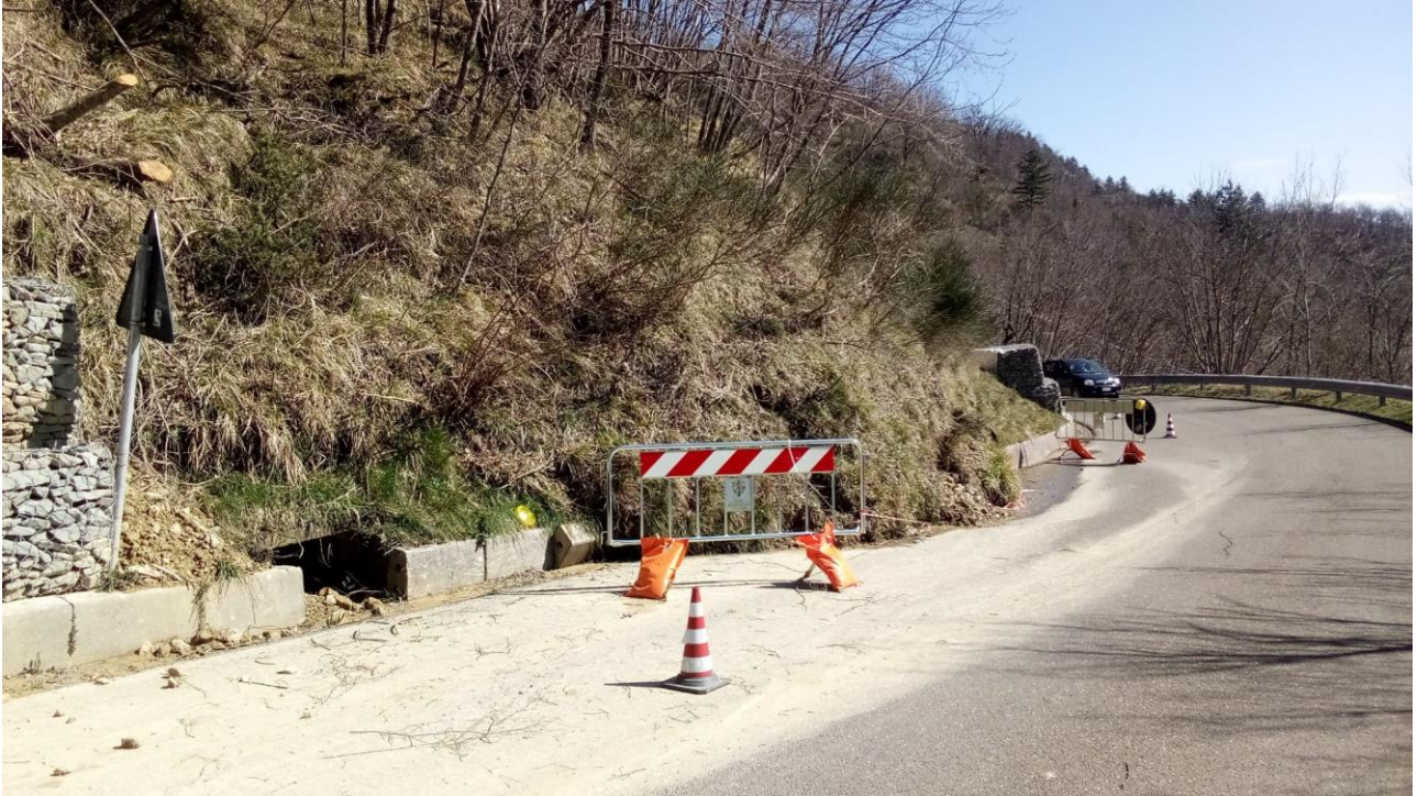
Foto 1: SP 32 frana di monte con presenza di materiale in strada
