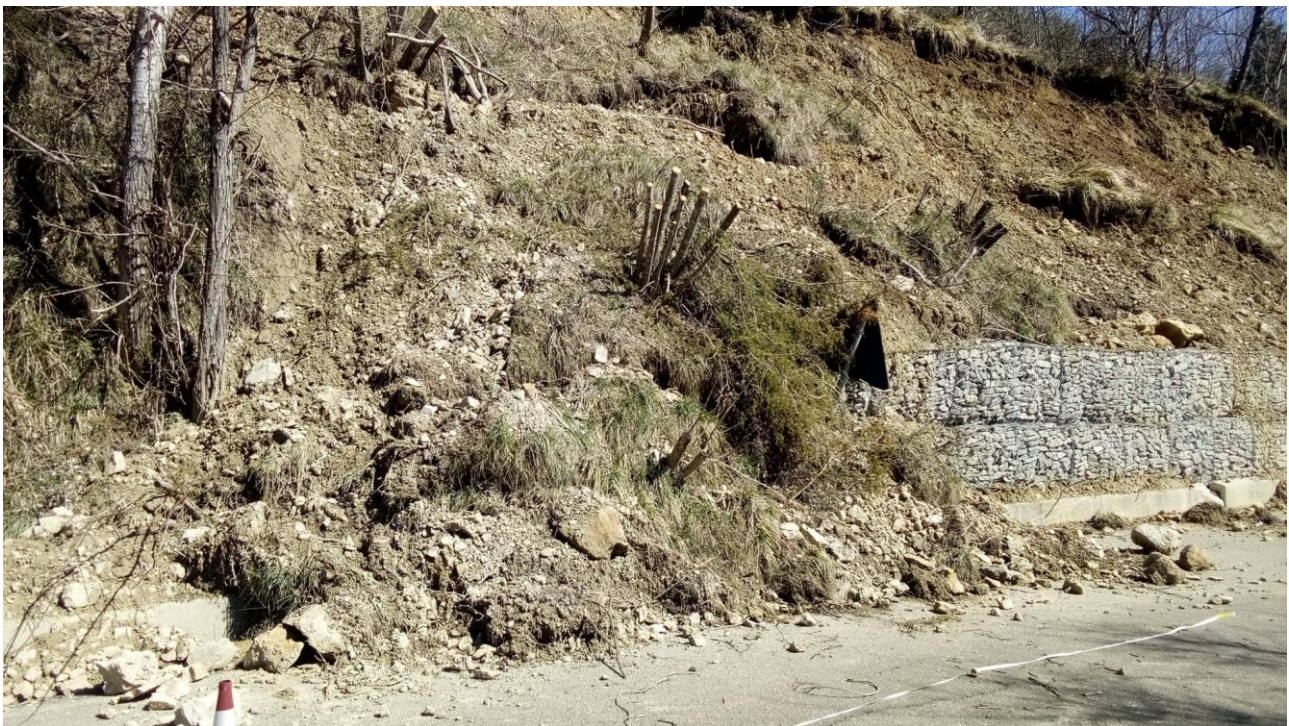
Foto 2: SP 32 frana di monte con presenza di materiale in strada
