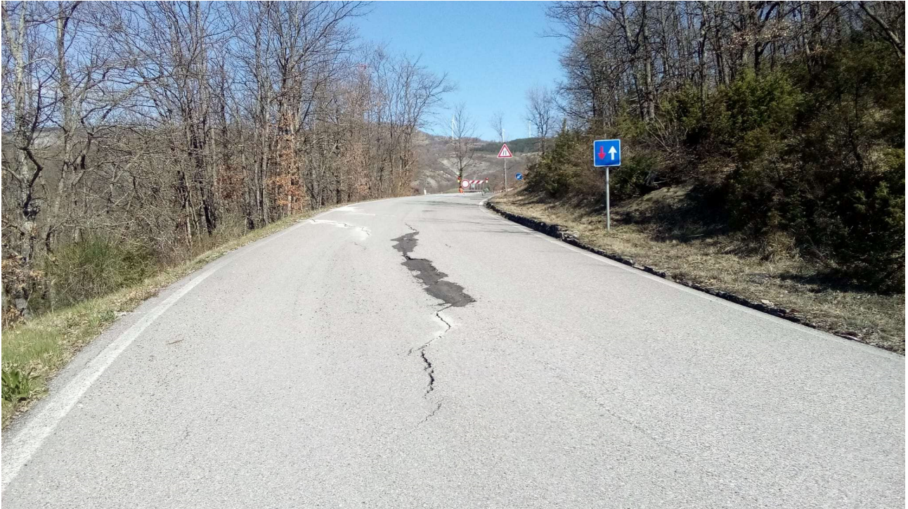
Fig 1 – Frana km 4+900 – tratto dove sono previsti i gabbioni lato valle
