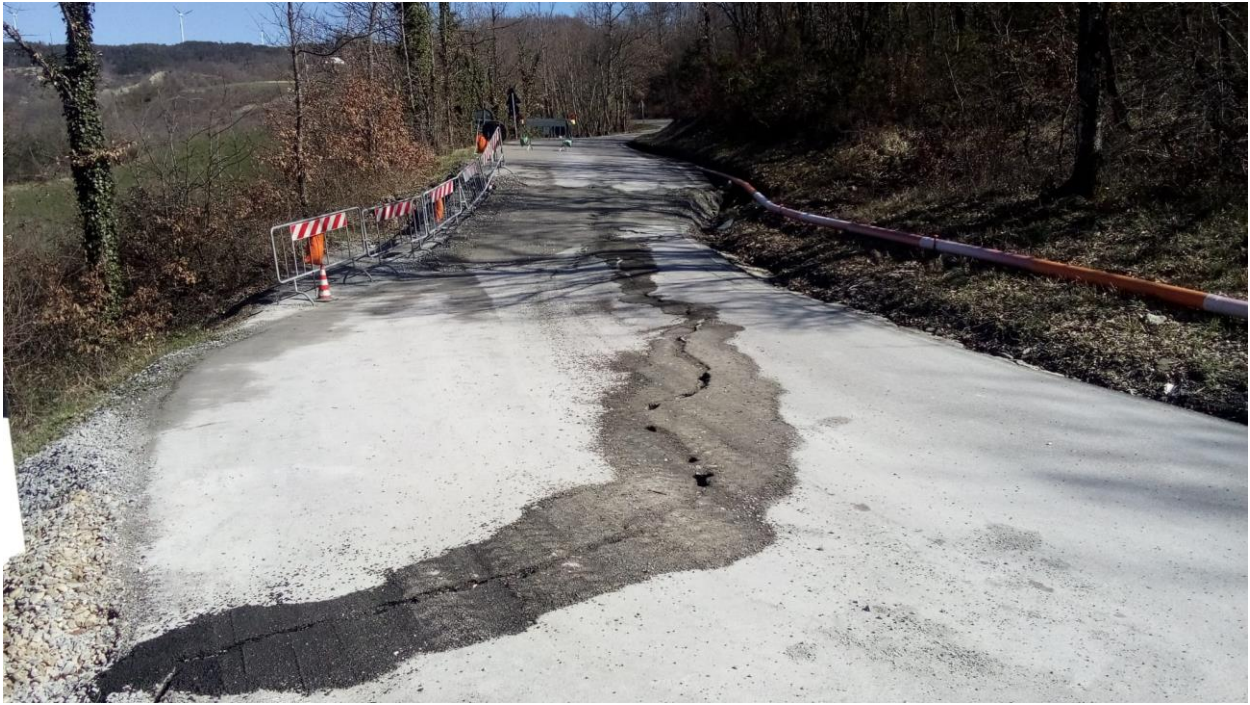
Foto 1: SP 117 dissesto carreggiata stradale a seguito di frana
