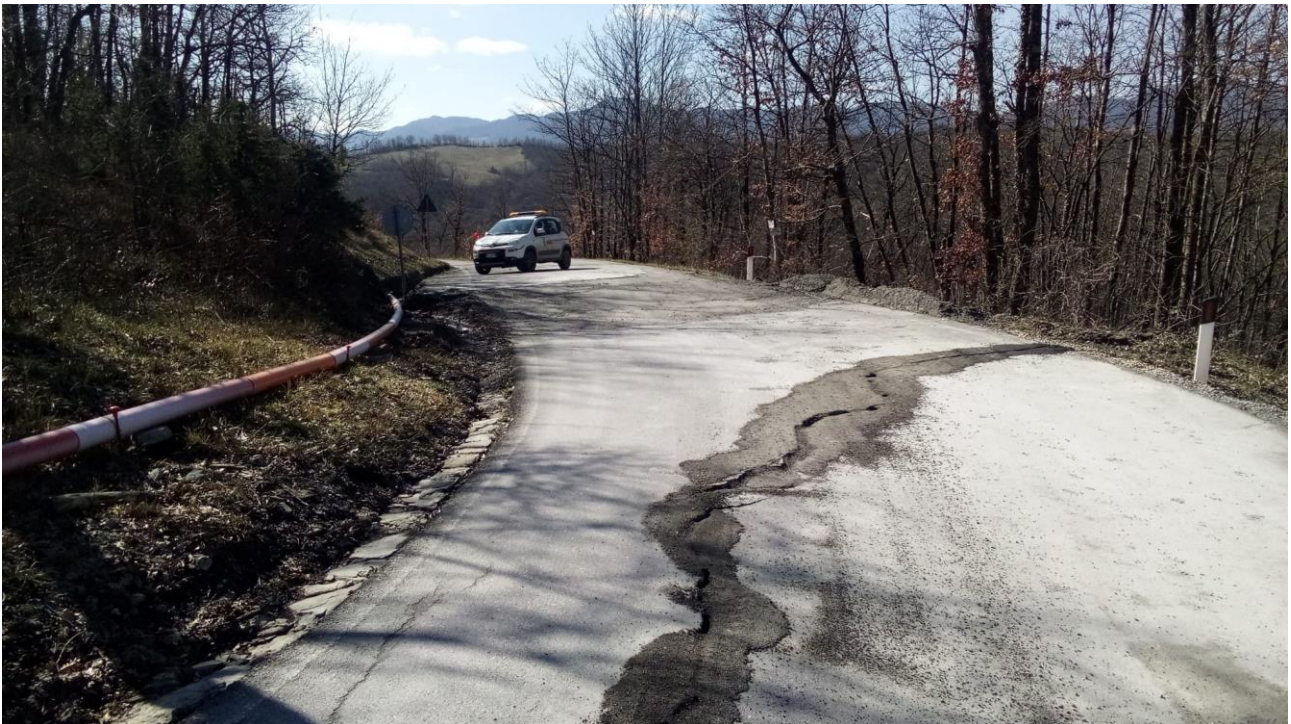
Foto 2: SP 117 dissesto carreggiata stradale a seguito di frana
