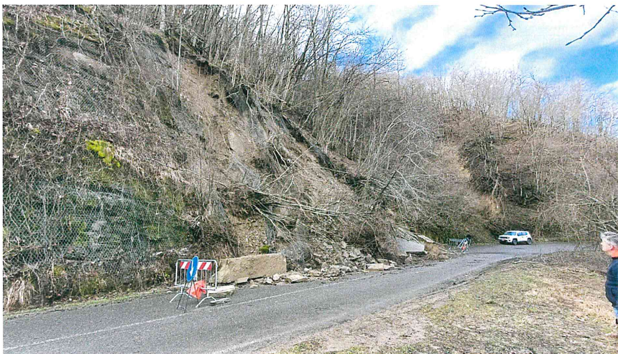
Foto 1: SP 74 frana di monte con rottura reti esistenti e materiale instabile in scarpata
