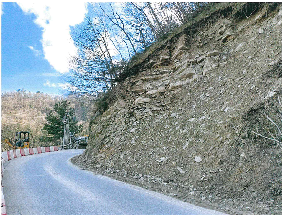
Foto 3: SP306 materiale instabile in scarpata e rischio caduta massi
