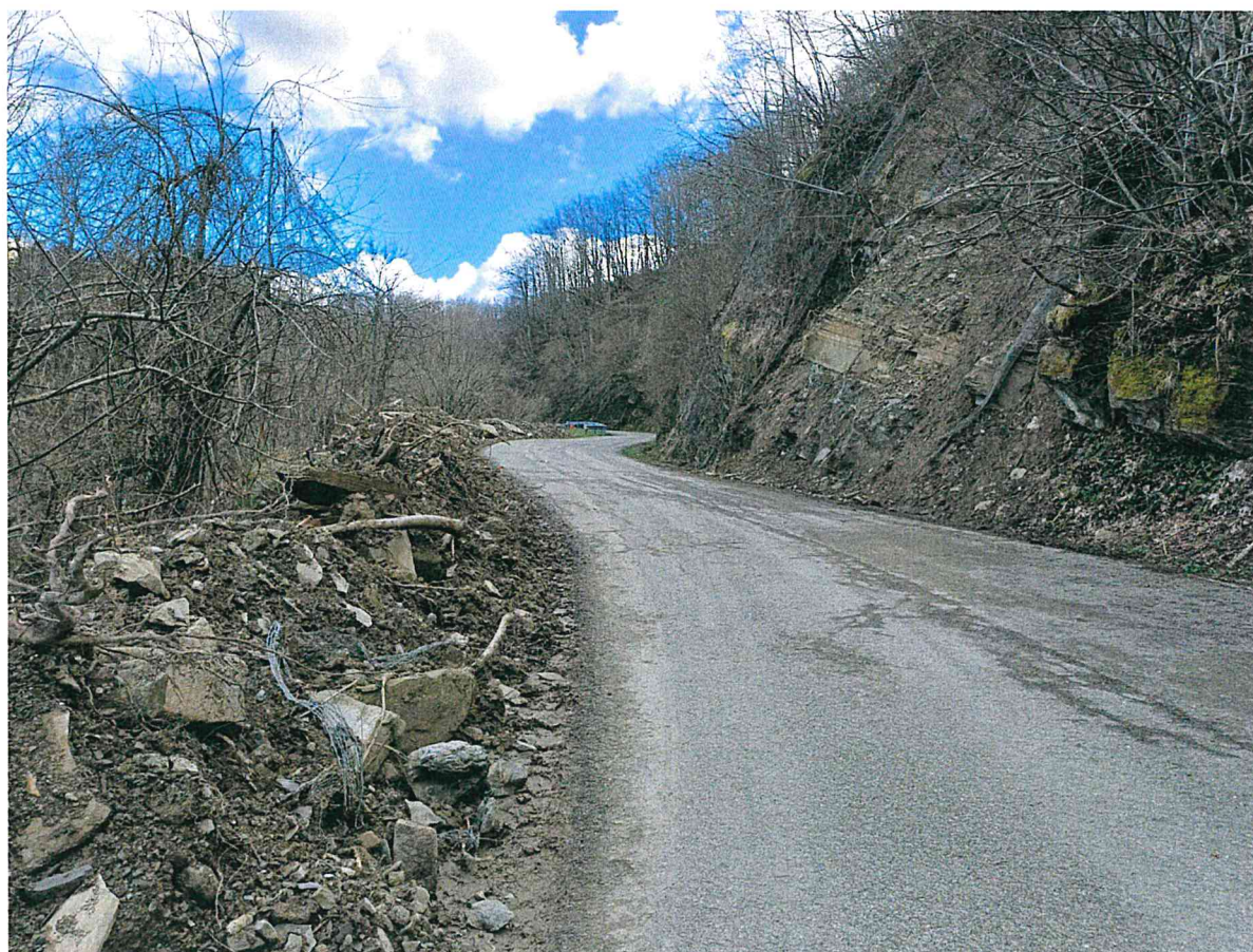
Foto 2: SP 74 frana di monte con rottura reti esistenti e materiale instabile in scarpata
