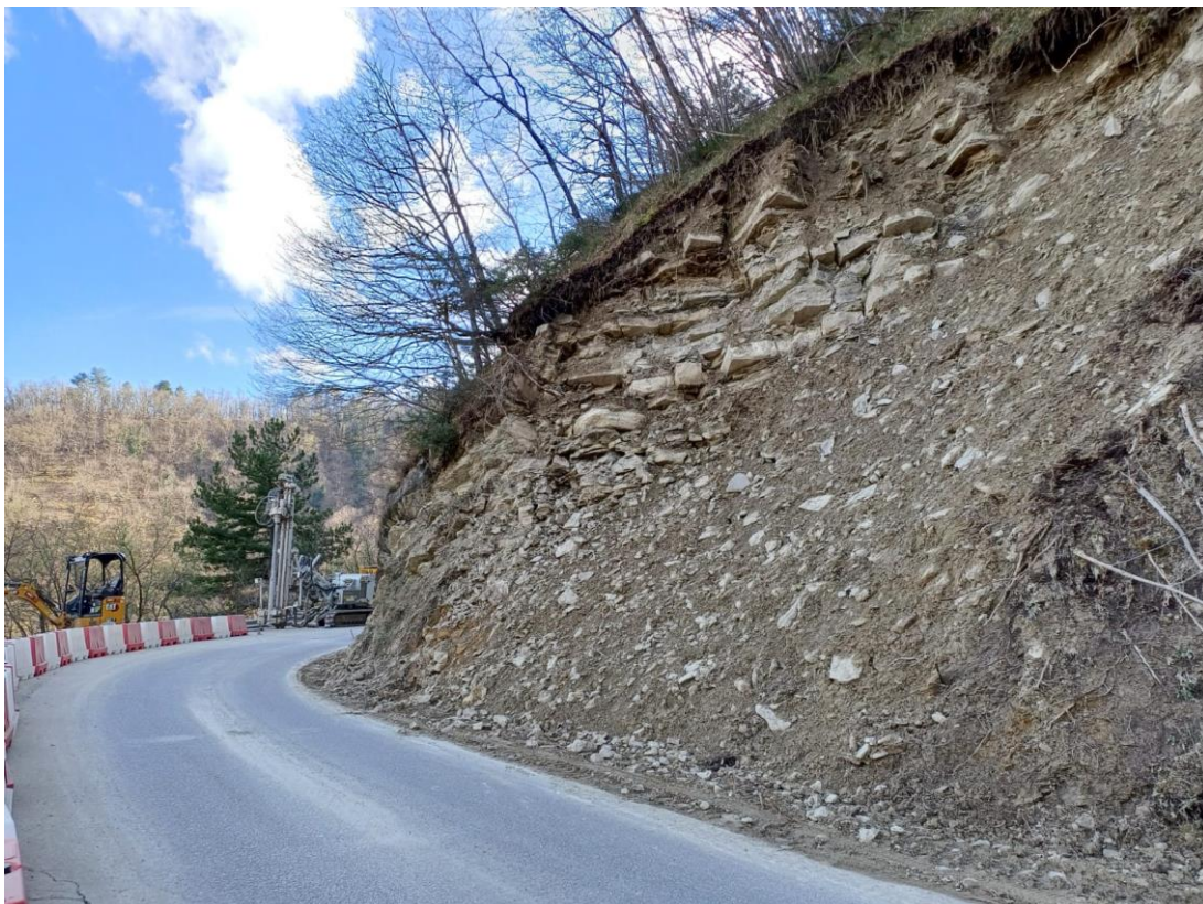
Foto 1: SP306 materiale instabile in scarpata e rischio caduta massi
