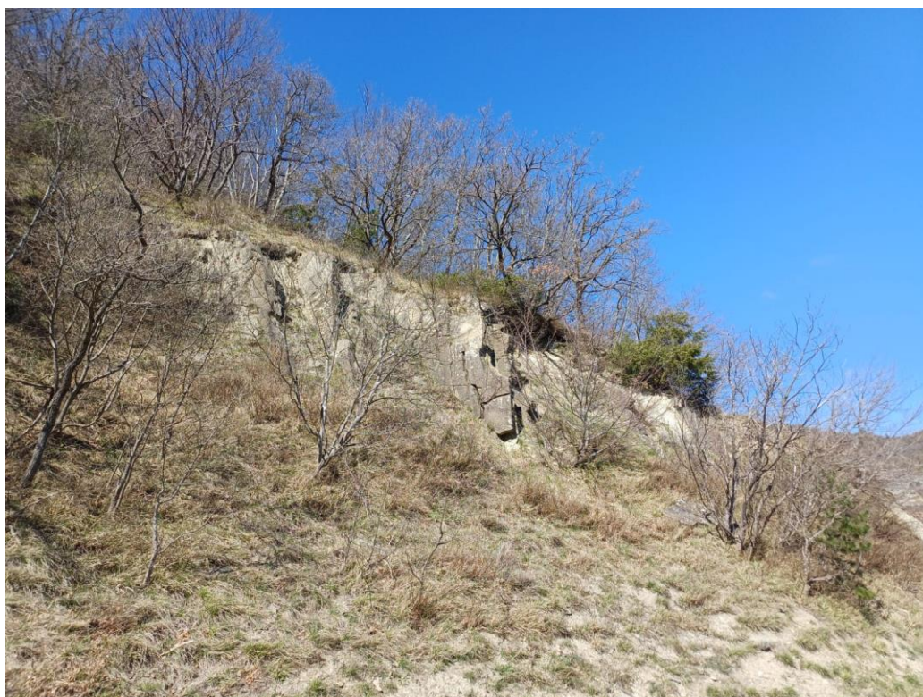
Foto 2: SP 306 massi ciclopici instabili ed in distacco presenti in scarpata
