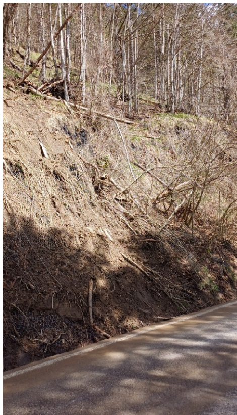
Foto 2: SR 302 materiale instabile in scarpata reti esistenti danneggiate e piene di detriti
