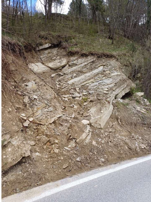
Foto 5: SR 302 materiale instabile in scarpata e rischio caduta massi
