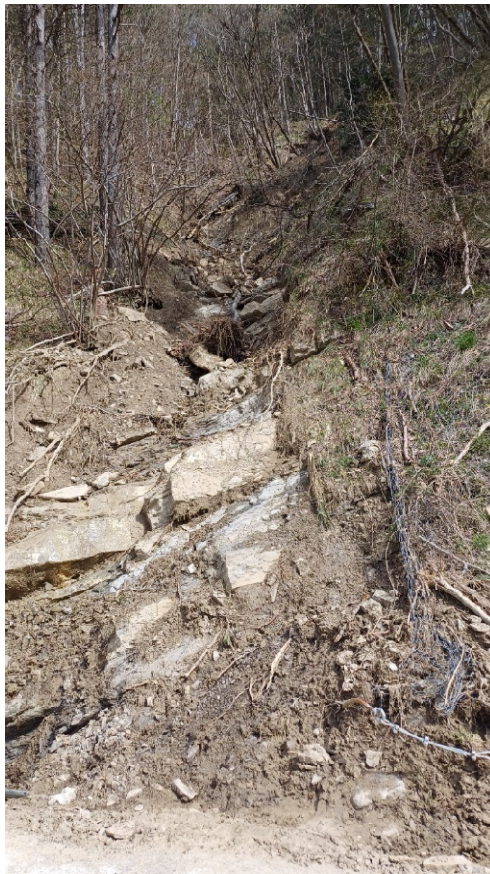
Foto 4: SR 302 materiale instabile in scarpata e rischio caduta massi
