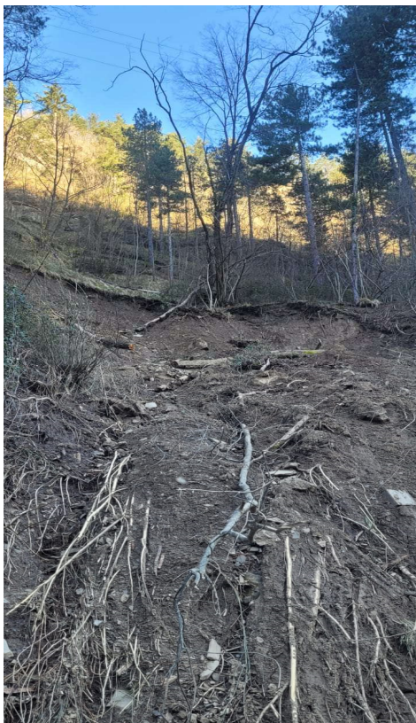
Foto 1: SR 302 materiale instabile in scarpata e rischio caduta massi
