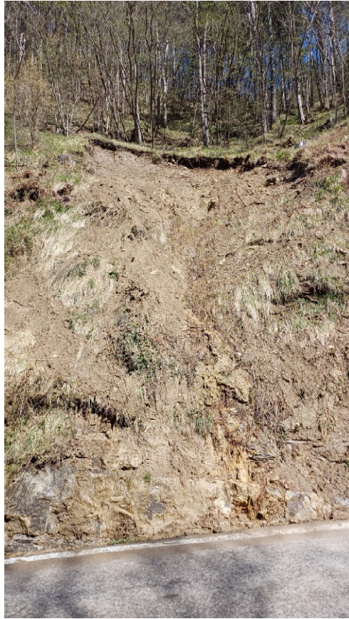
Foto 3: SR 302 materiale instabile in scarpata e rischio caduta massi
