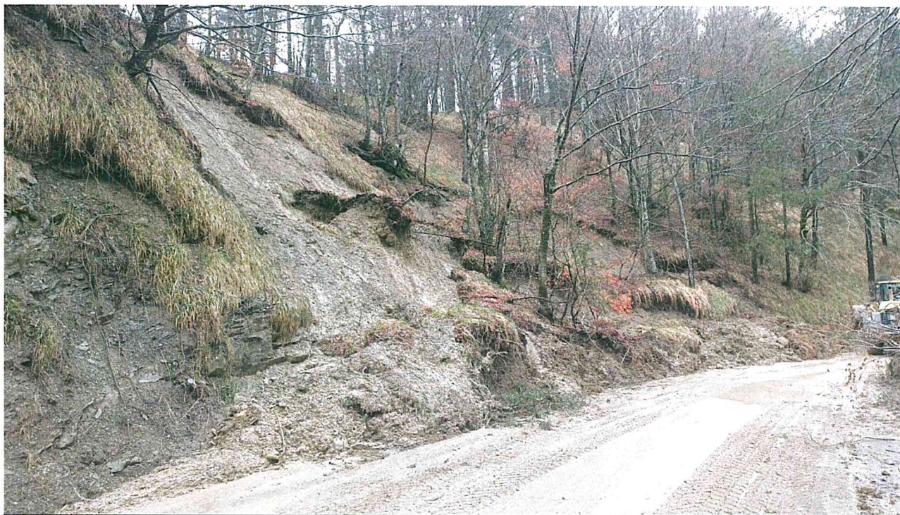
Foto 1: SR 302 materiale instabile in strada
