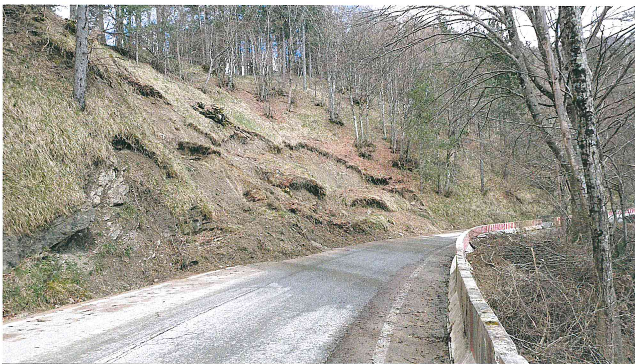
Foto 2: SR 302 materiale instabile in strada
