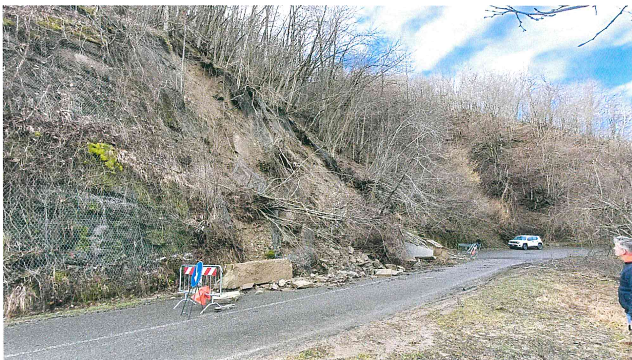
Foto 3: SP 74 al km 12+000 frana di monte con presenza di materiale in strada
