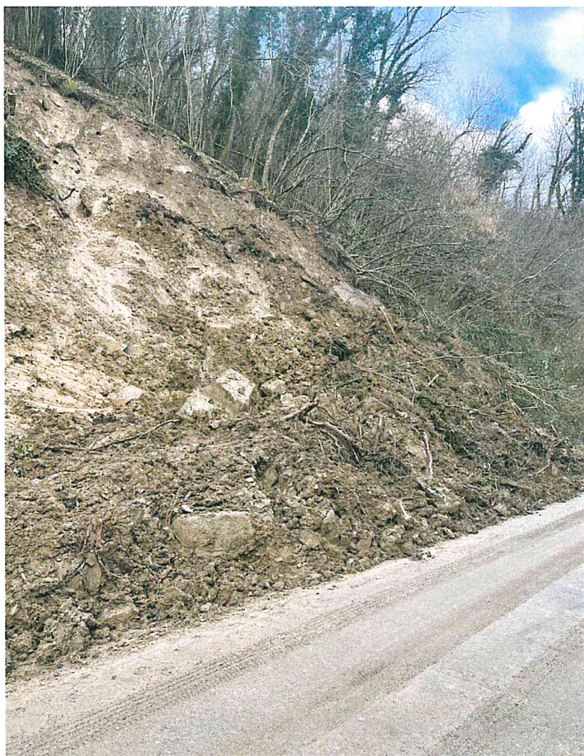
Foto 2: SP 306 al km 35+000 frana di monte con presenza di materiale in strada
