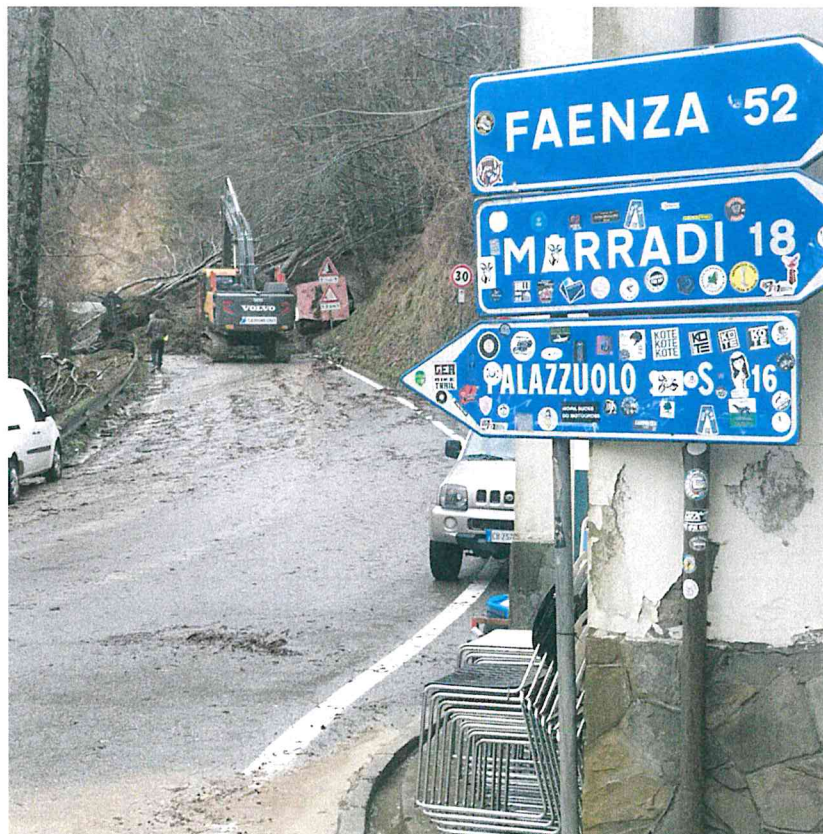
Foto 1: SP 477 al km 16+100 frana di monte con presenza di materiale in strada
