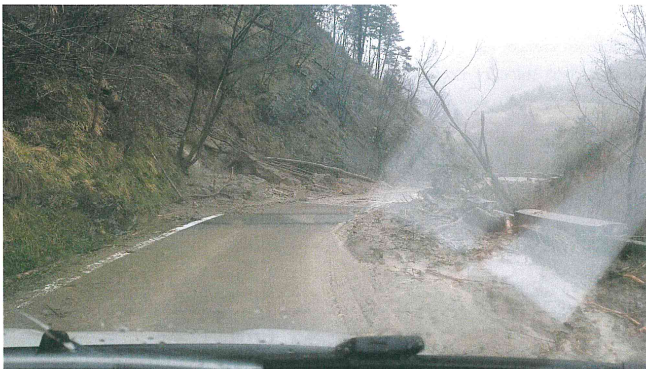
Foto 2: SR 302 frana di monte con presenza di materiale in strada
