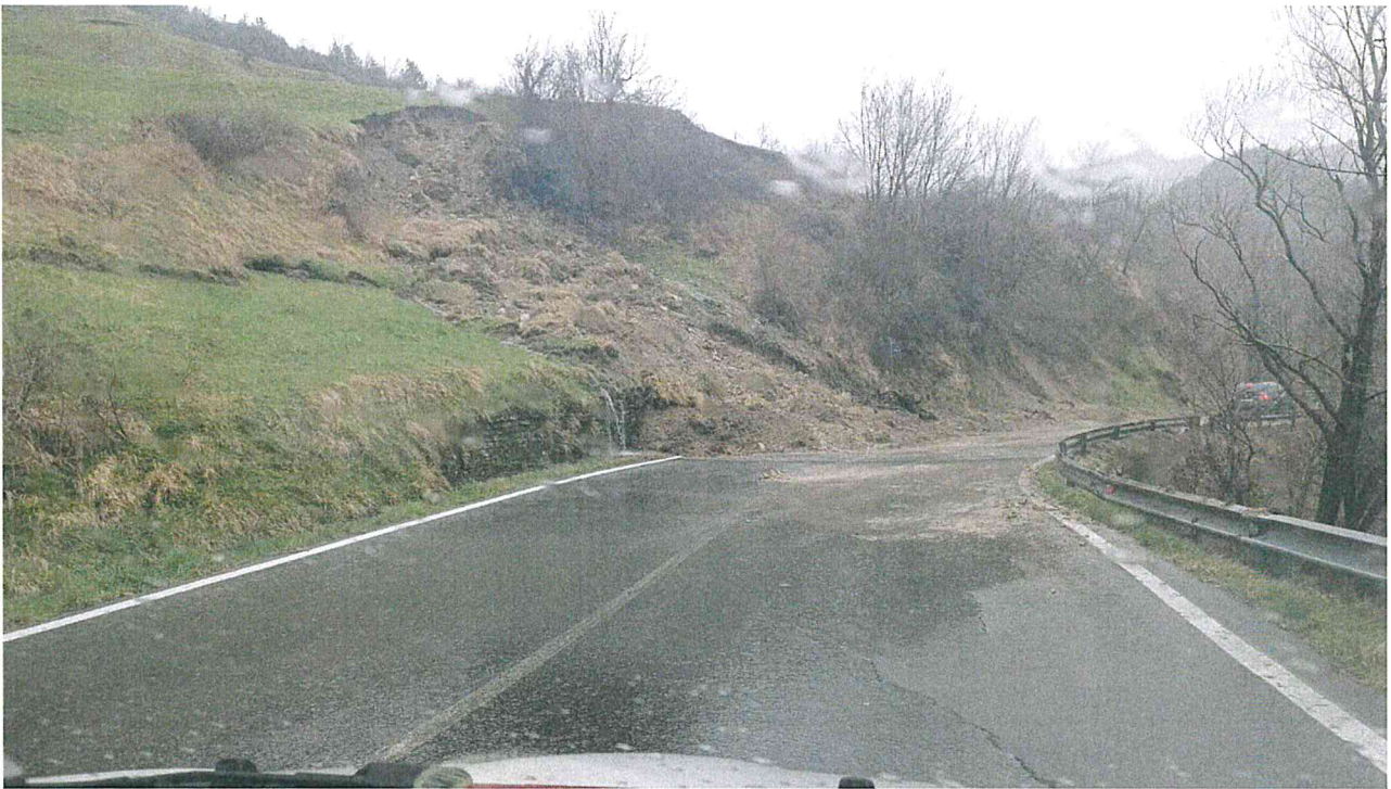
Foto 1: SR 302 frana di monte con presenza di materiale in strada
