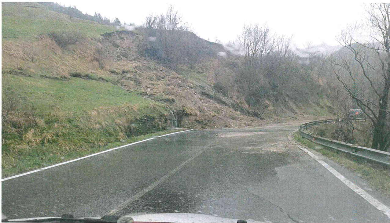
Foto 4: SR 302 km 52+600 frana di monte con presenza di materiale in strada
