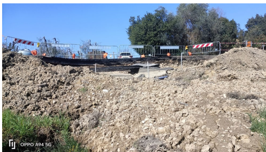
Area della strada in dissesto alla data del sopralluogo
