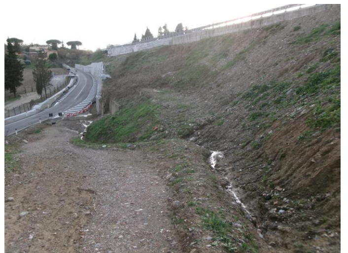
Foto 6 – Vista da Nord a valle del dissesto.
