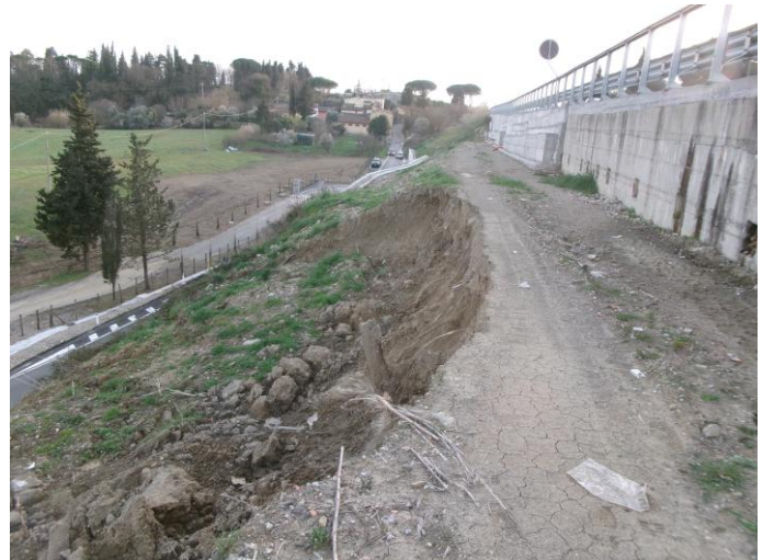
Foto 4 – Vista da Nord a monte del dissesto.
