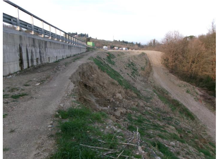
Foto 2 - Vista dallo stradello a monte del rilevato in dissesto.
