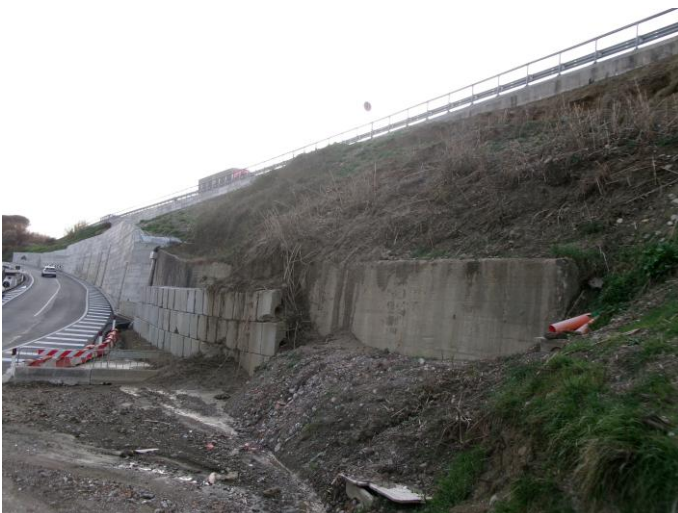
Foto 5 – Vista a valle del dissesto.
